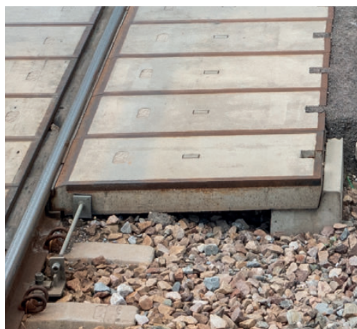
Małogabarytowe płyty przejazdu kolejowego
