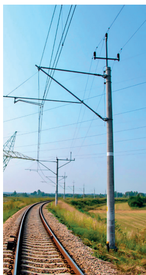
SŁUPY TRAKCJI KOLEJOWEJ
