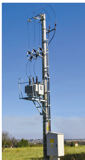
SŁUPOWE STACJE TRANSFORMATOROWE
