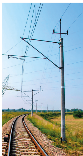
SŁUPY TRAKCJI KOLEJOWEJ ETG
