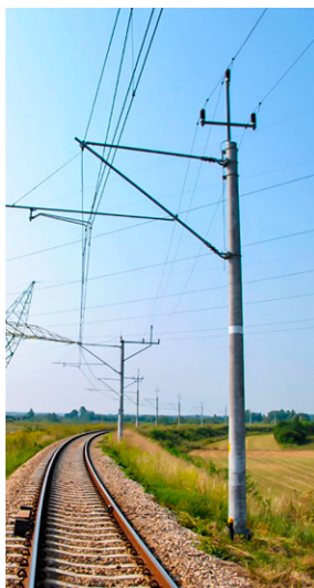
SŁUPY TRAKCJI KOLEJOWEJ ETG
