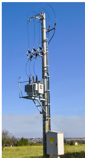
SŁUPOWE STACJE TRANSFORMATOROWE
